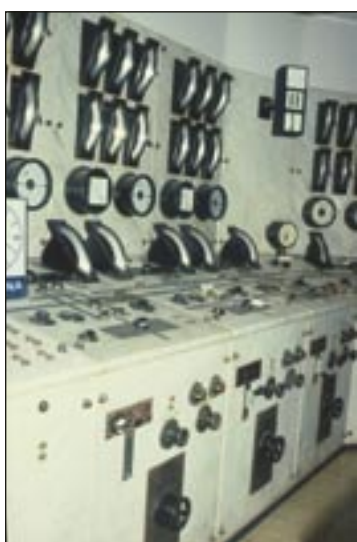
FIGUR 3-1 KONTROLLROM I KRAFTSTASJON
