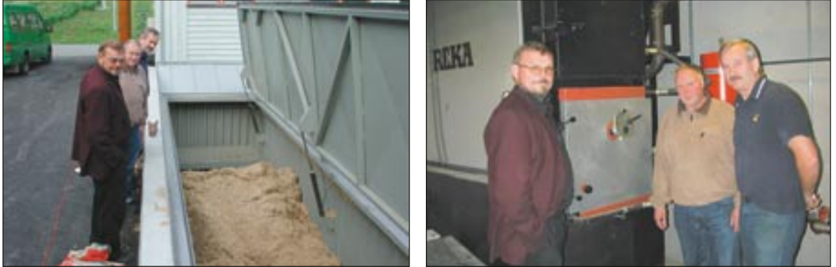
FIGUR 11-1 FLISFYRINGSANLEGG PÅ VOSS JORDBRUKSSKULE, MED FLISLAGER OG OMN
